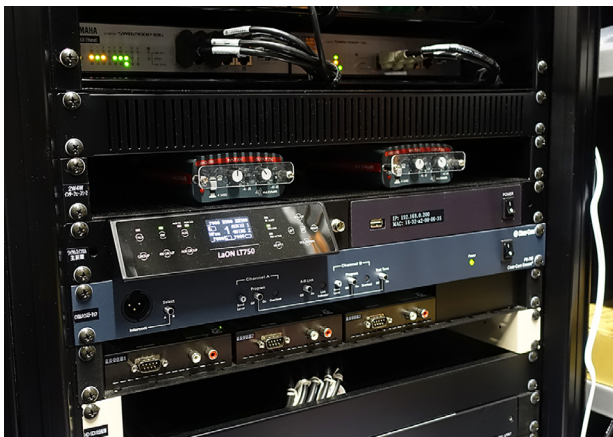
音響調整室に設置されているベースステーション BS750
