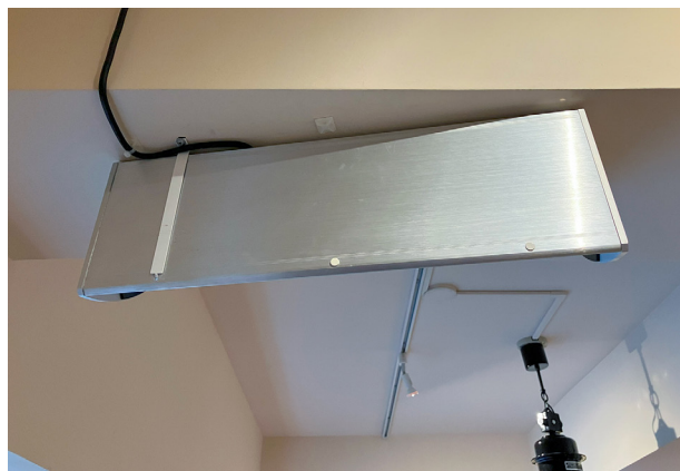
本体を固定する専用金具は天井と 4 点で固定されているが、セキュリティ策としてブラケット (左の白い板) も取り付けられている
