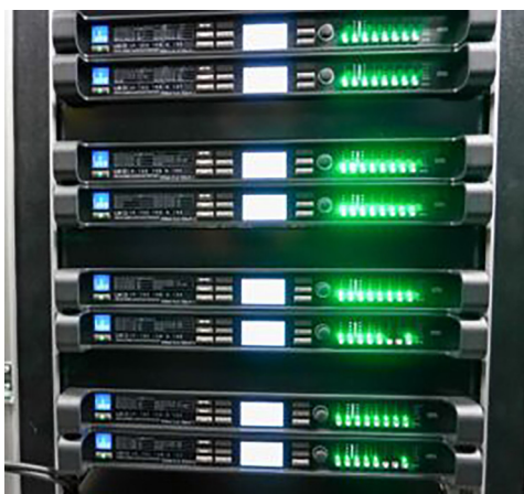
大ホール（中ホール）アンプ室
