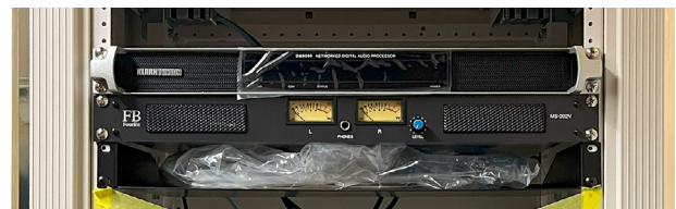
機材室のDM8500(上)。下は中音を確認するためのラック用モニタースピーカー。(施工時)
